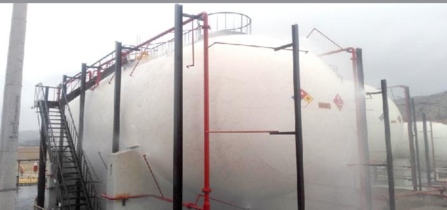
Planta de almacenamiento Solgas Ventanilla.
