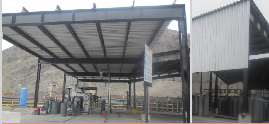
Planta de envasado de GLP Solgas Ventanilla.
