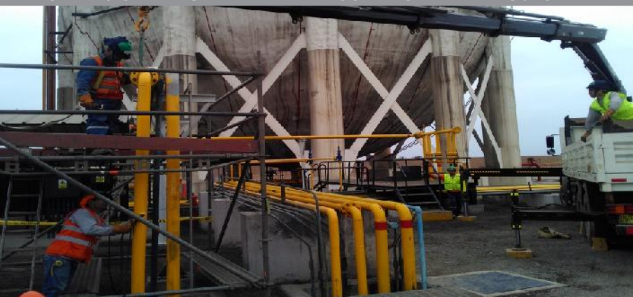
Planta de almacenamiento Solgas Ventanilla.
