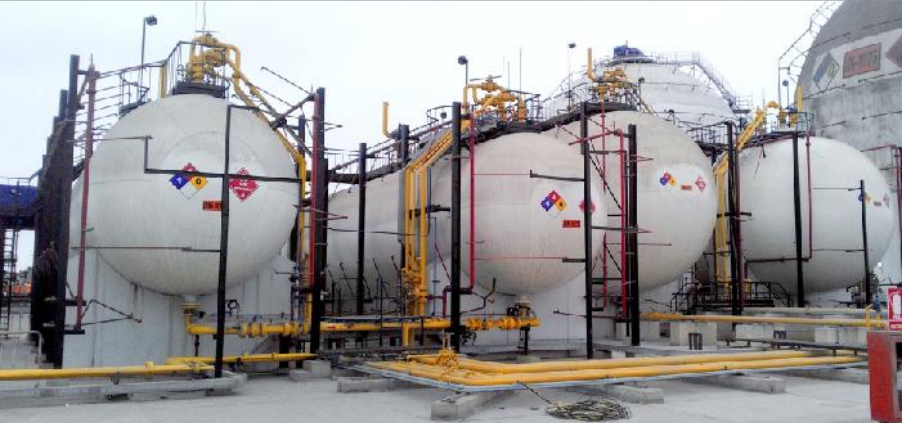
Planta de almacenamiento Solgas Ventanilla
