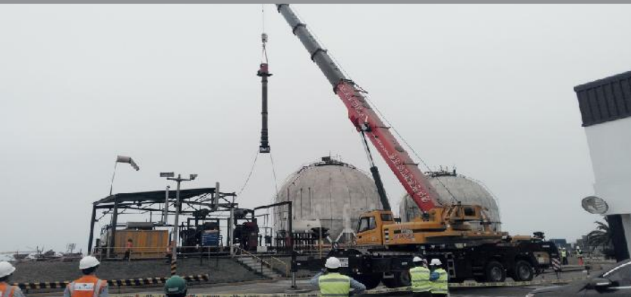
Planta de almacenamiento Solgas Ventanilla
