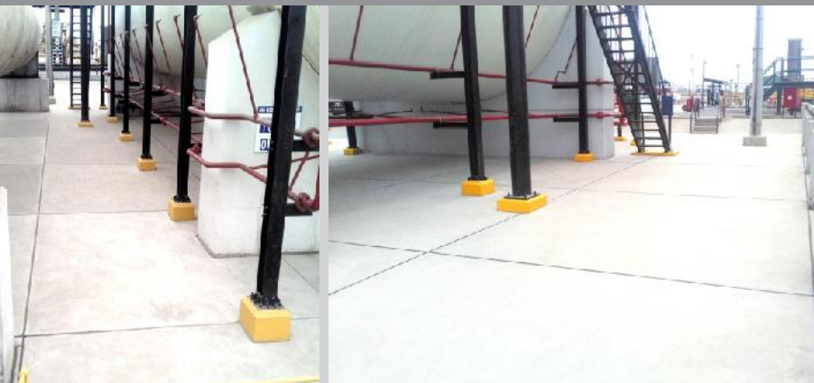
Planta de almacenamiento Solgas Ventanilla.
