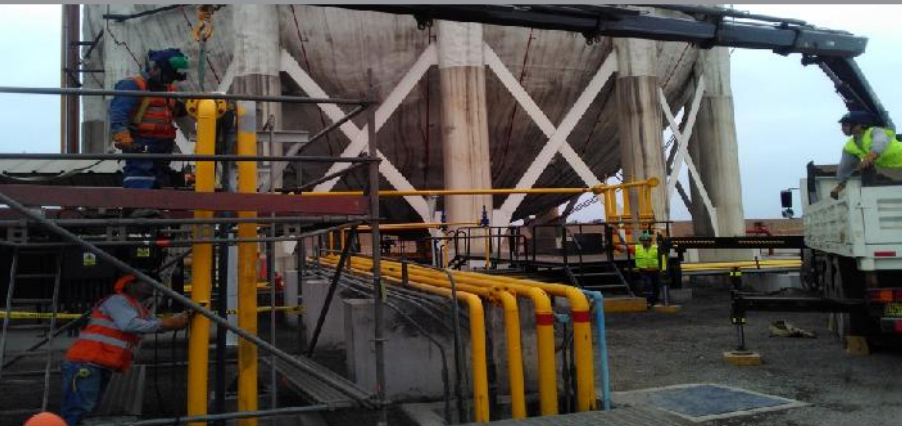
Planta de almacenamiento Solgas Ventanilla.
