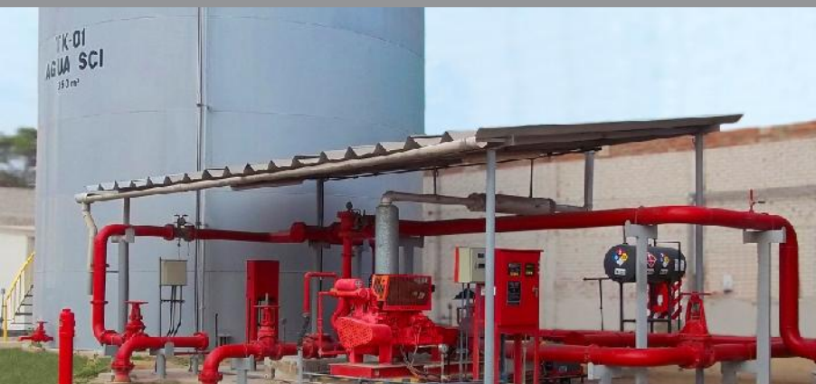
Planta de envasado de GLP Repsol Huancayo y Tarapoto.
