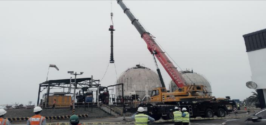
Planta de almacenamiento Solgas Ventanilla
